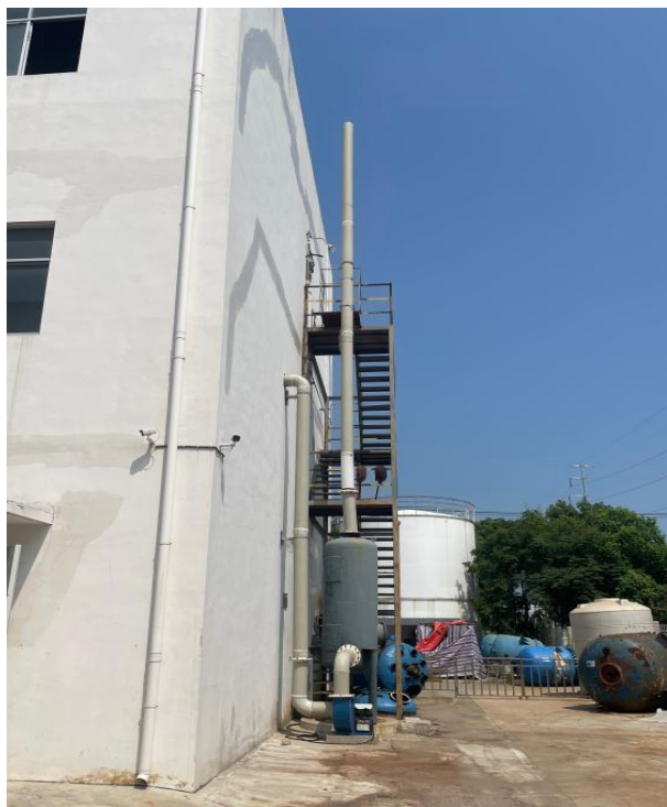
危废间废气收集排气筒
