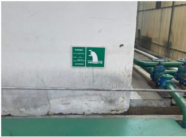
厂区废水排放口及标识牌
