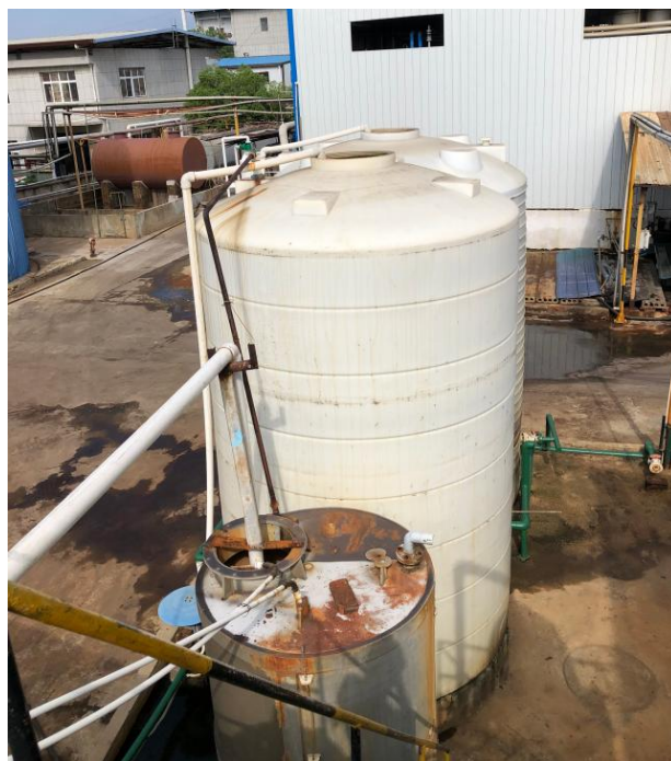
污水处理站废气处理药剂（碱液桶）
