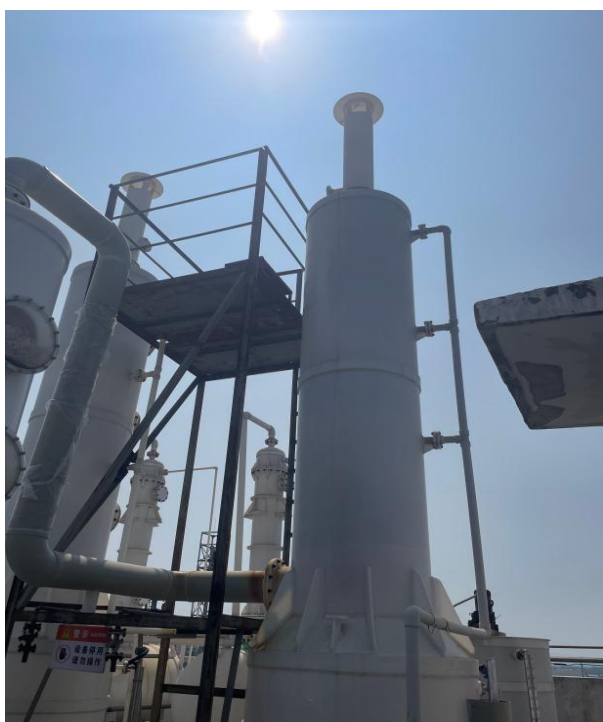
排气筒及采样平台
