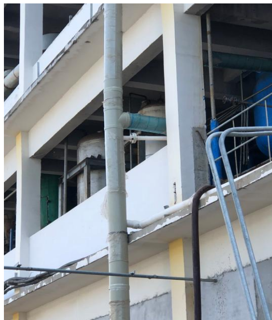
工艺废气管道
