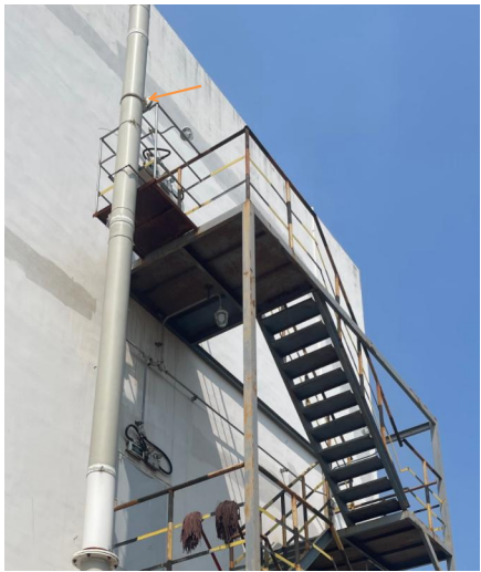
DA007 排气筒监测孔及采样平台
